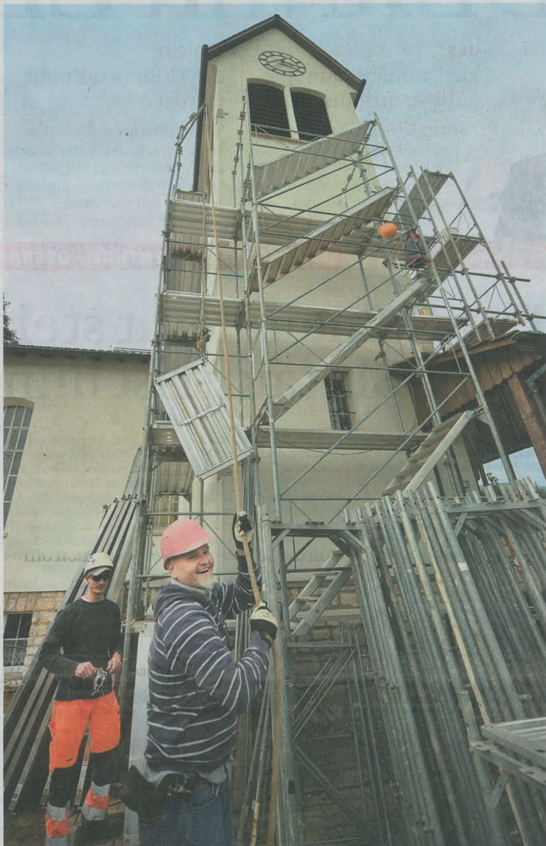
Rosa wie seinen Helm will Reto Bärtschi den Attiswiler Kirchturm streichen. Gestern haben Handwerker dem Künstler das Gerüst gestellt. Hinter der Abdeckung des Baugerüsts wird er nun an seinem Werk arbeiten. Thomas Peter
